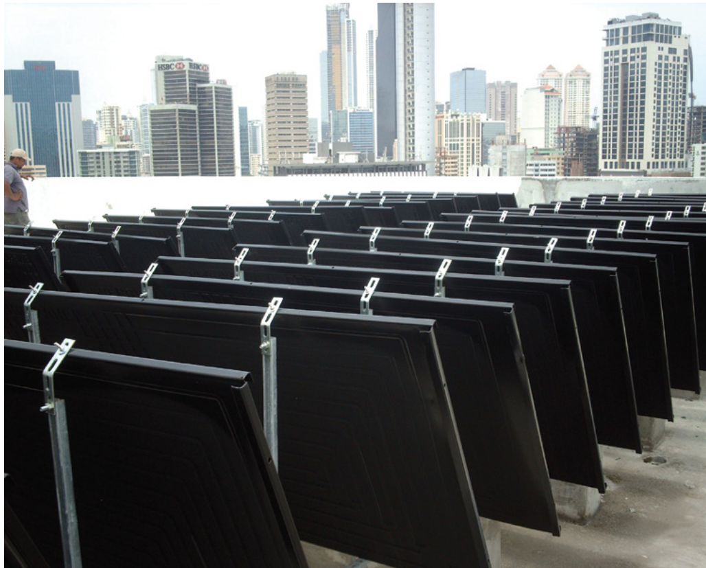
INSTALACIÓN DE ENERGY PANEL EN UN HOTEL DE PANAMÁ PARA AGUA CALIENTE SANITARIA
